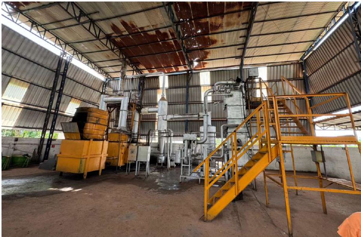
FIGURA 68 – INCINERADOR MUNICIPAL DESATIVADO
